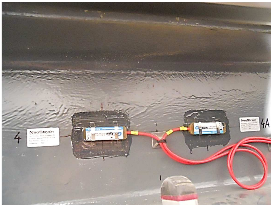
Rys. 6. Przykład czujników zamontowanych do elementu kratownicy po odtworzeniu powłok malarskich na konstrukcji
