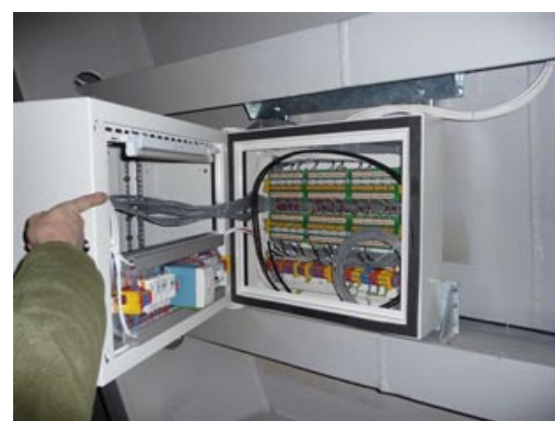
Fot. 5. Widok wnętrza serwera lokalnego zlokalizowanego na moście
